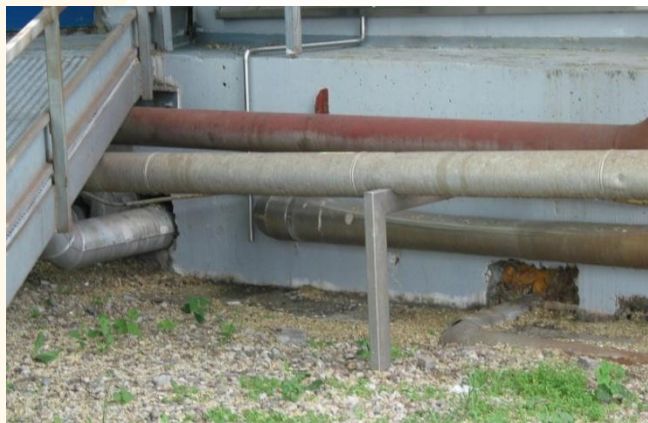
Ryc. 1. Obiekt wymagający uszczelnienia
