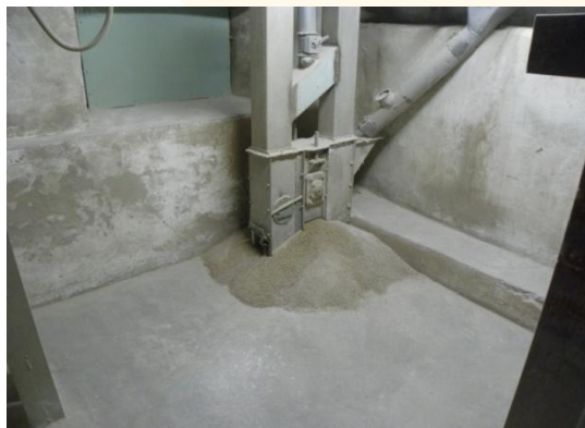
Ryc. 3: Zebrane resztki starych produktów i śmieci należy natychmiast usunąć z pomieszczenia
